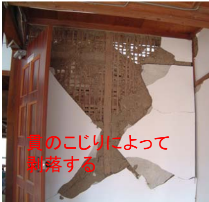
中越地震の土壁の被害
